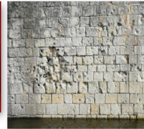
Traces d'impacts sur la muraille ouest.
